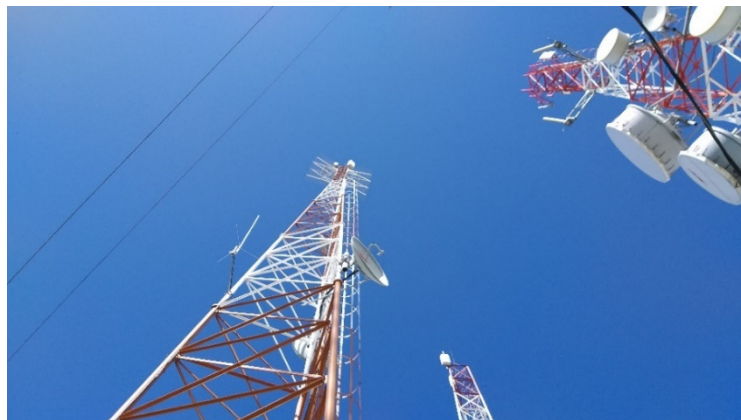
Figura 12.- Sistema radiante montado en la torre, (Foto autoría propia).
