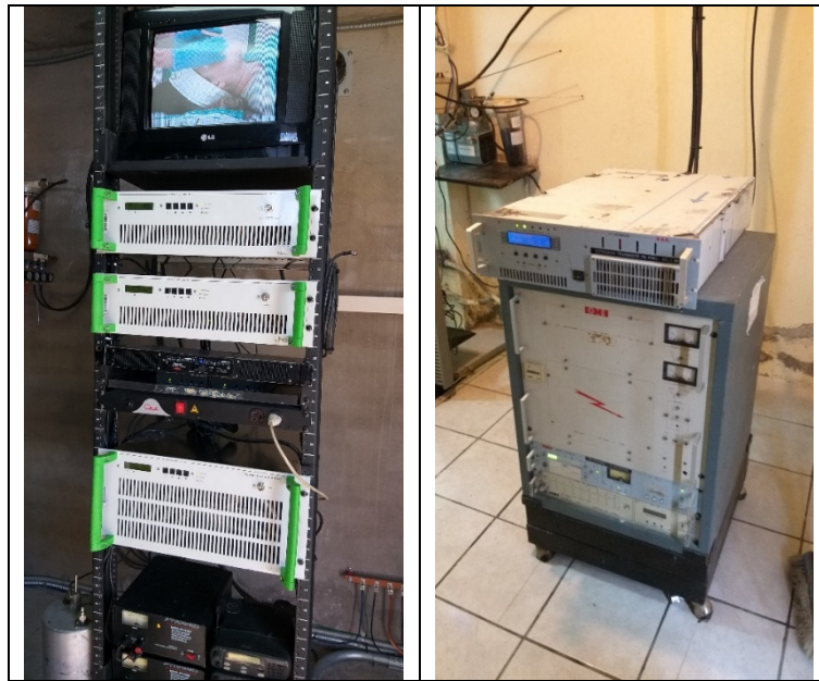
Figura 11. Sistemas de Radio y Televisión en una estación, (Foto autoría propia).
