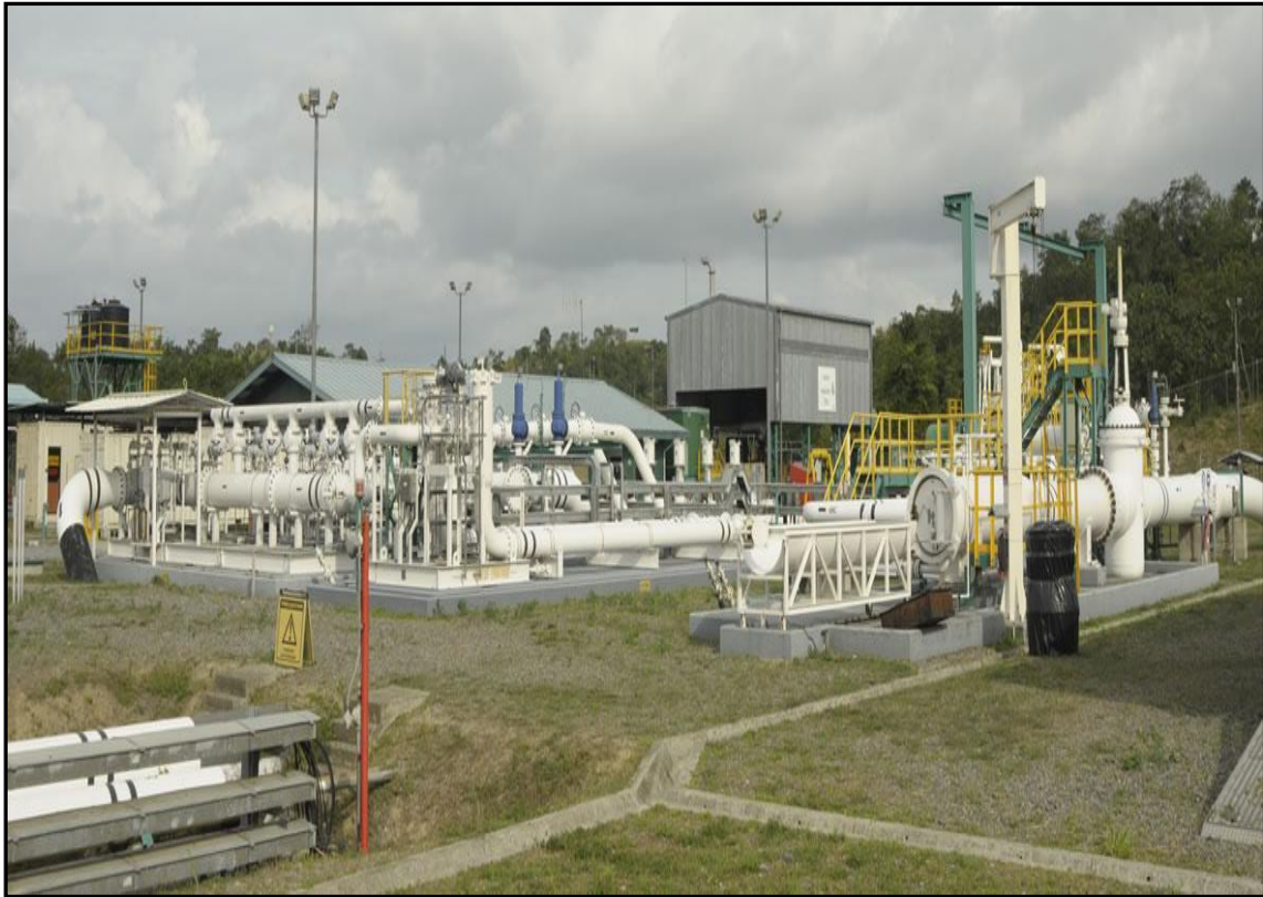
Fotografía # 9: Instalaciones de bombeo TEPRE
