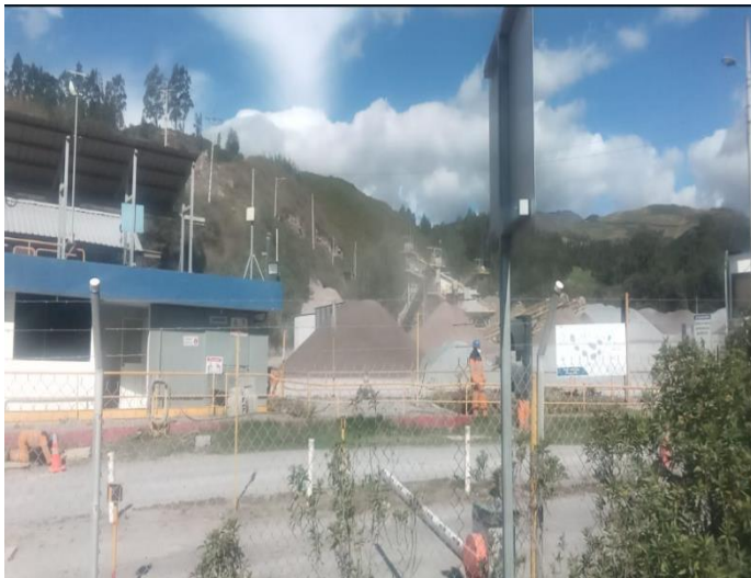
Ilustración 2.2 Planta de agregados Pifo
