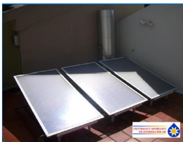
Figura 118 Colectores Solares de Agua Caliente
