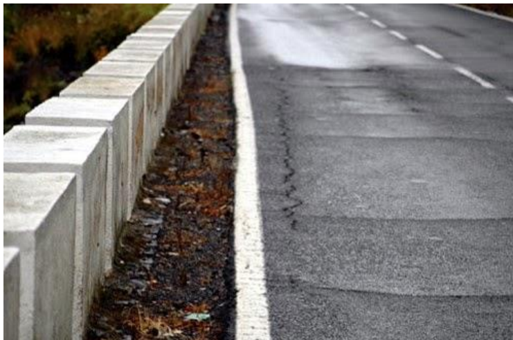
Imagen 12 Grieta en el borde.
