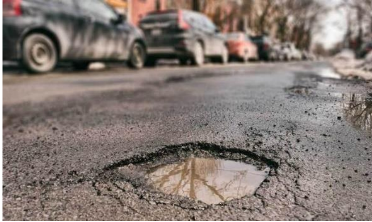
Imagen 13 Un bache en una vía de asfalto.
