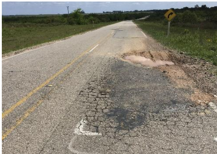
Imagen 10 Asfalto fallando por baja temperatura.
