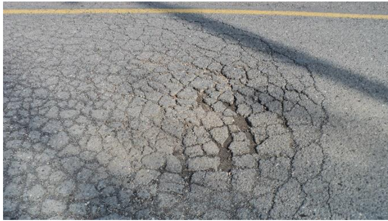
Imagen 11 Asfalto claramente agrietado
