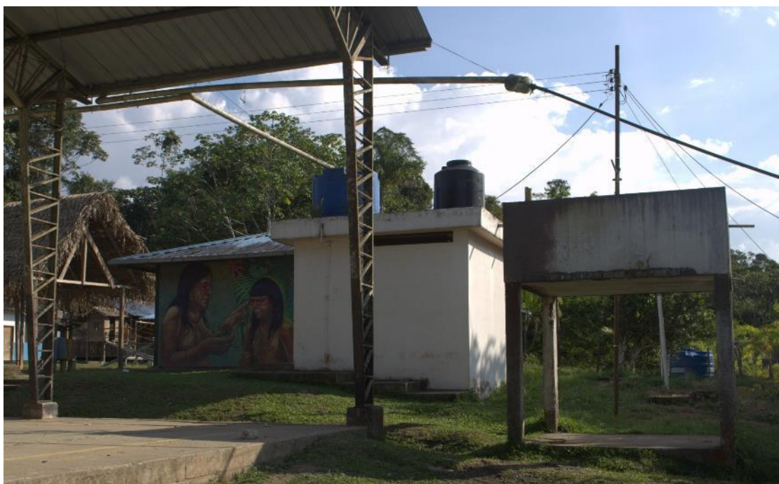
Fotografía 9. Canales para recolección de agua en cubierta de coliseo. Autoría Propia.
