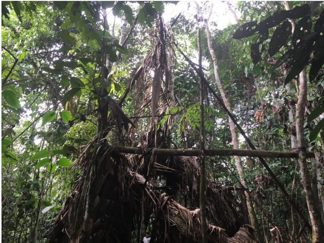
Fotografía 11. Cabaña típica waorani en deterioro. Autoría Propia.
