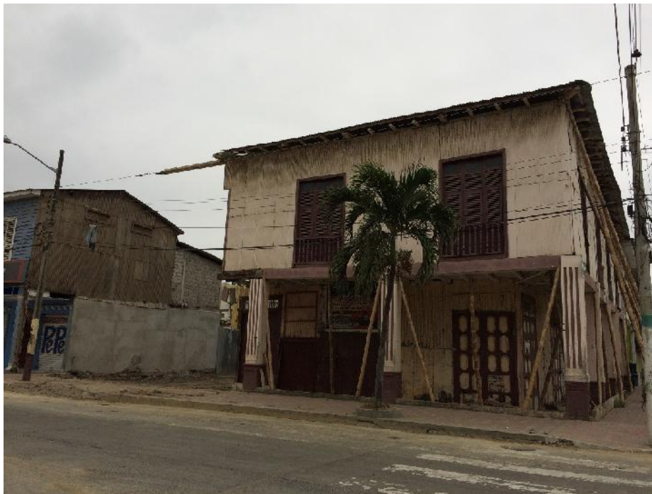
Ilustración 41 Vivienda patrimonial apuntalada y deshabitada. Fuente: Elaboración propia, 2016.
