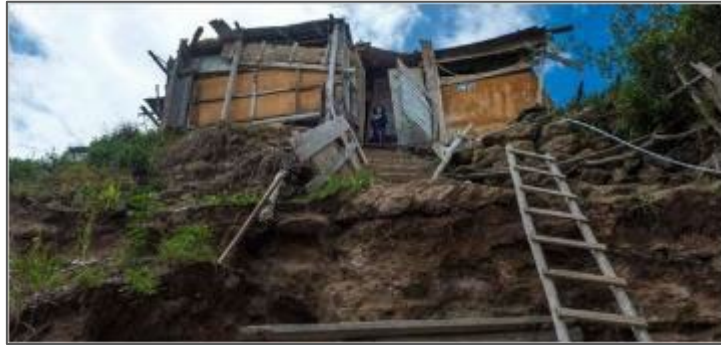
Ilustración 2 casa en zona de riesgo (fuente: diario El Telégrafo)
