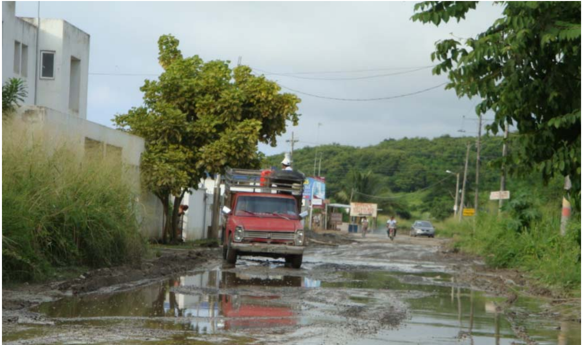
C4. Foto 7. Problemática de la Zona: Acumulación de Agua Lluvia, Calle 26, entre Estero y Av. E.
