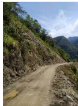
Imagen 4 Via de Suelo Natural en estado regular
