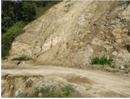
Imagen 7 Zona de frecuentes derrumbes
