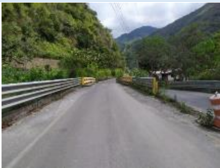
Imagen 9 Puente de capa de rodadura de asfalto en estado regular, falta de mantenimiento
