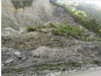
Imagen 1 Deslizamiento de tierra en la vía
