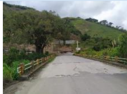
Imagen 10 Puente de capa de rodadura de asfalto estado regular, falta de mantenimiento
