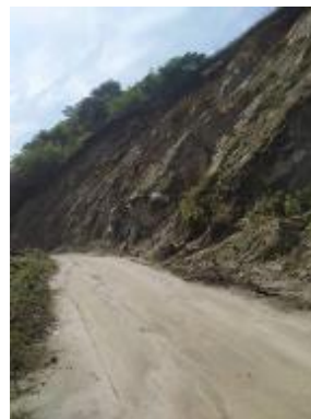
Imagen 6 Zona de frecuentes derrumbes
