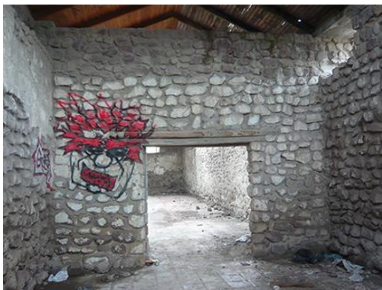
Figura 20: Hacienda en actual deterioro
