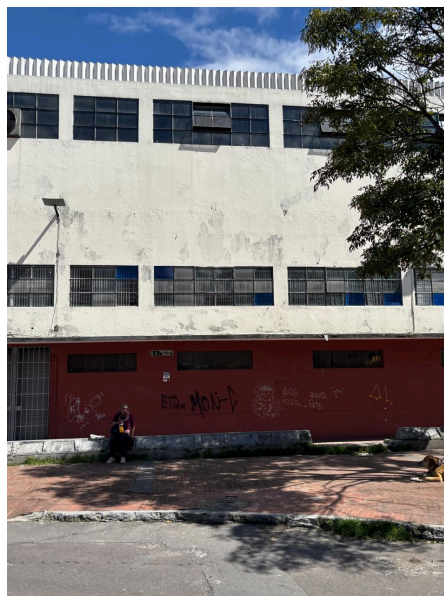
Imágen 8. Fachadas deterioradas. Autoría Propia
