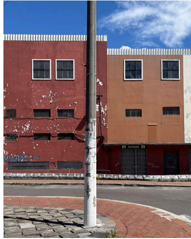
Imagen 1. Desgaste de fachada del Coliseo Julio César Hidalgo . Autoría Propia
