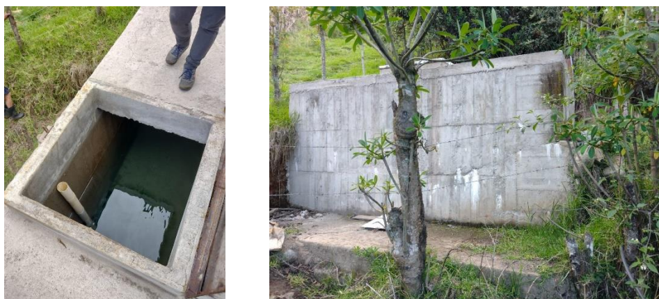
Figura 15. Sistema de reserva actual
