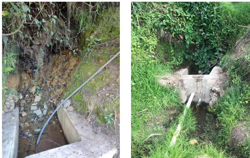
Figura 13. Sistema de captación actual
