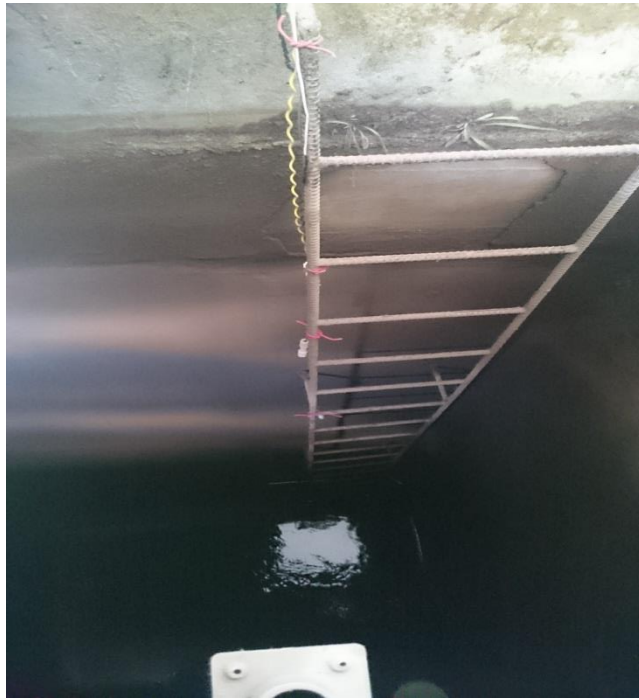
Pruebas de detección del sensor controlador de nivel del reservorio
