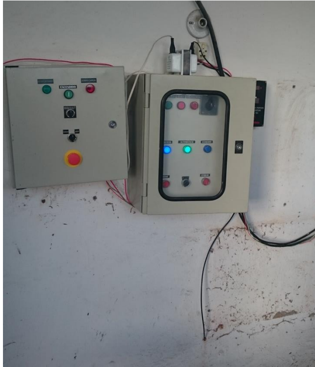
Pruebas de funcionamiento Sistema de control y monitoreo
