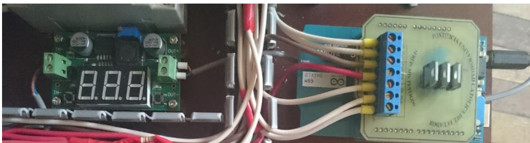
Fig. 28 Alimentación para unidad de control y monitoreo Arduino Fuente: La Autora
