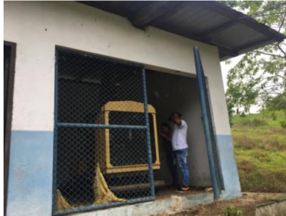
Fotografía 20. Estado actual del cuarto de generación de energía eléctrica del proyecto. Elaboración Propia.
