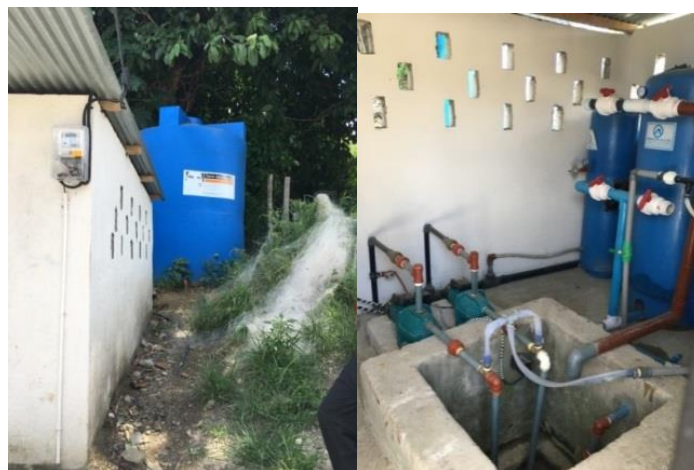
Fotografía 22. Sistema de grifos distribuidos en dos partes de la parroquia colocados por la
