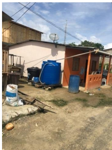
Fotografía 10. Sistema de recolección de agua lluvia adaptado a vivienda. Elaboración propia.
