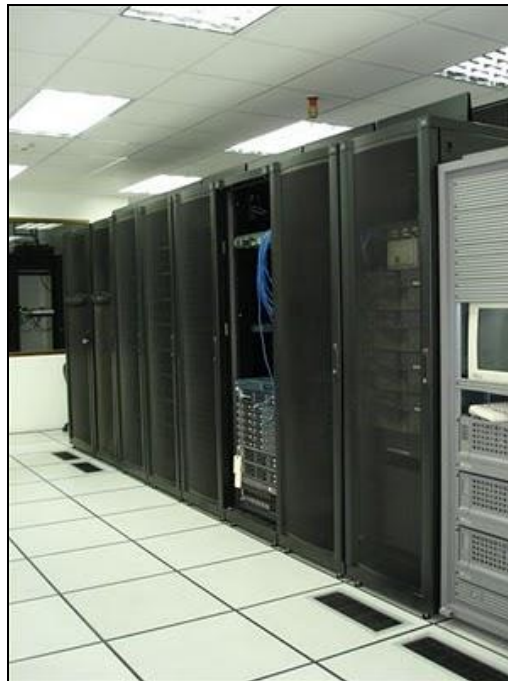
Figura 1-02: Cuarto principal de equipos [2]
