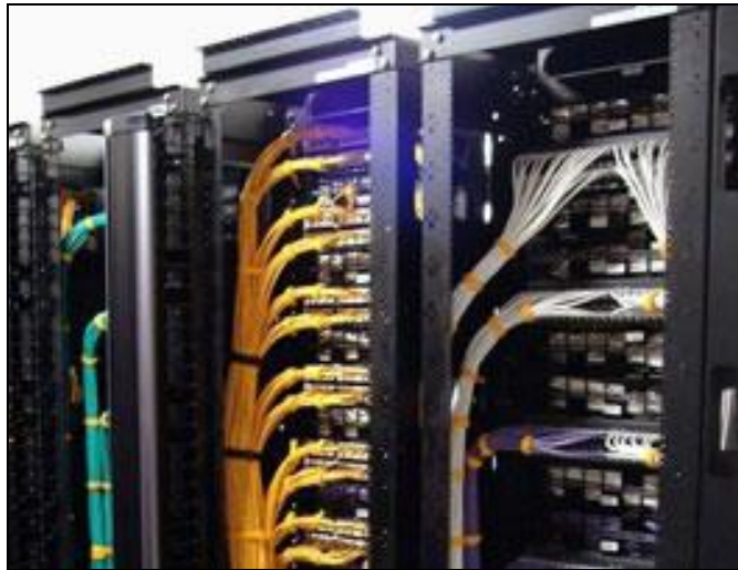
Figura 1-03: Cuarto de comunicaciones [3]
