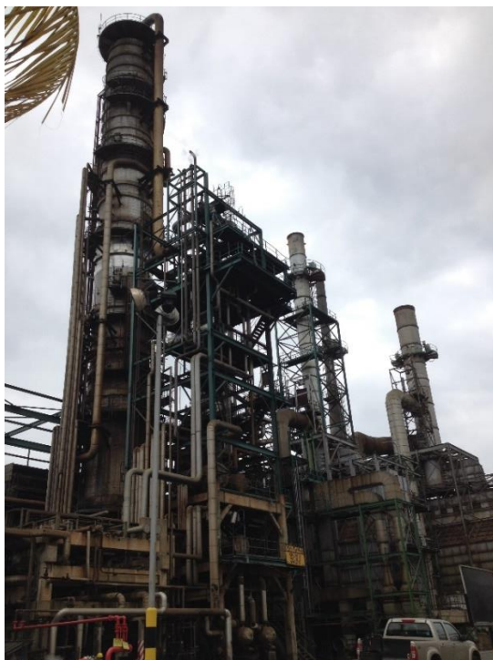
Fotografía 14. Torre Atmosférica y Unidad de Vacío 2 en la Refinería de Esmeraldas
