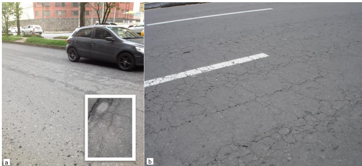
a) Daño por humedad y desprendimiento de material en Av. González Suárez (5 años de servicio) b) Fatiga en Av. de los Granados (6 años de servicio)
