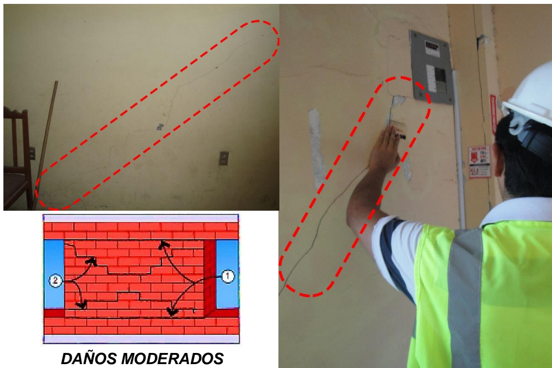
Figura 90: Muros Cortos o Pilastras: Rotación Muro o Pilastras (ENDE) – “Vivienda del Sr. Walter Santos”.
