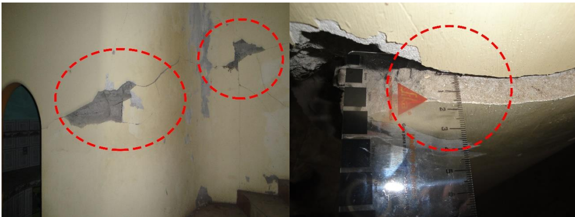
Figura 91: Muros Cortos o Pilastras: Deslizamiento de Juntas Horizontales (ENDE) – “Vivienda del Sr. Walter Santos”.
