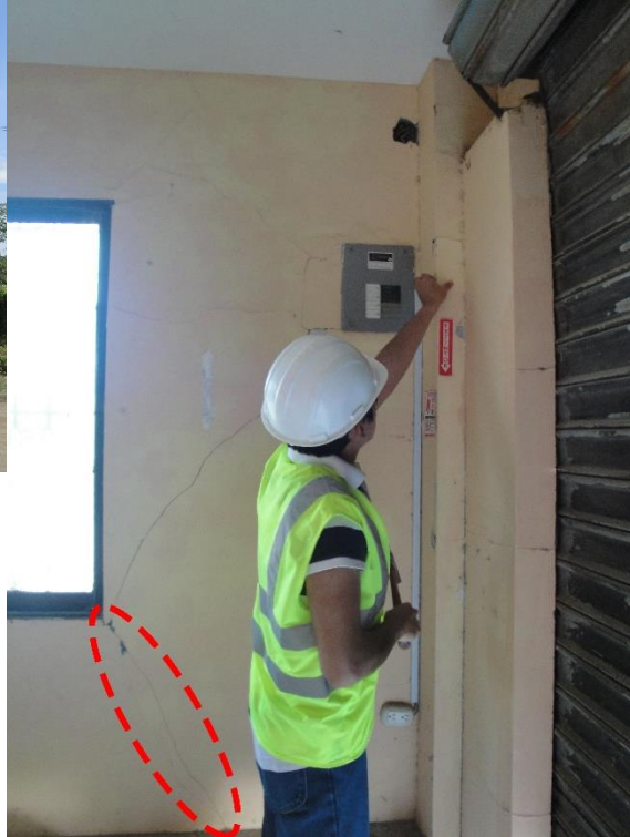
Figura 93: Dinteles y Antepecho: Rotación en Elementos de Soporte (ENDE) – “Vivienda del Sr. Walter Santos”.
