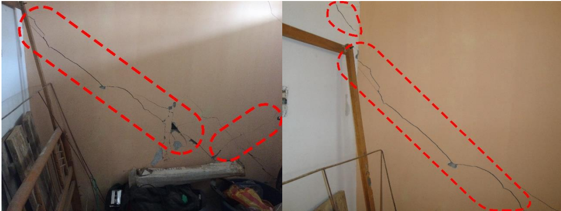
Figura 95: Muros Fuertes: Flexión / Rotura de la Base / Deslizamiento de las Juntas Horizontales (ENDE) – “Vivienda del Sr. Walter Santos”.
