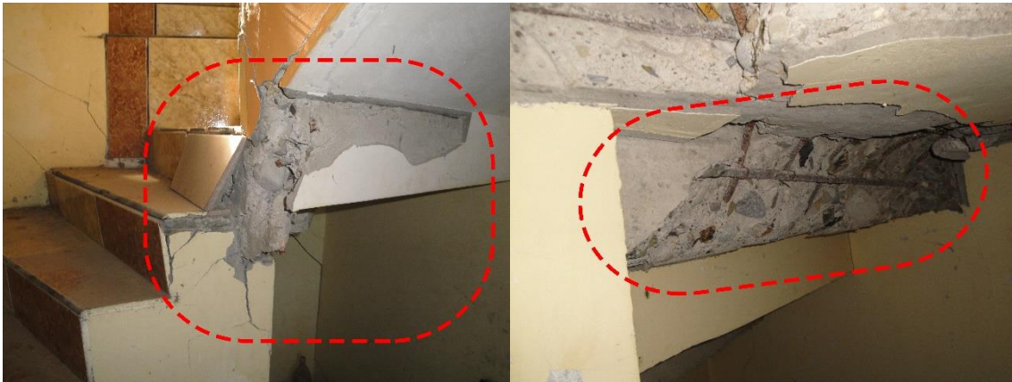
Figura 106: Escaleras: Daño en Escaleras de Hormigón Armado – “Vivienda del Sr. Walter Santos”.
