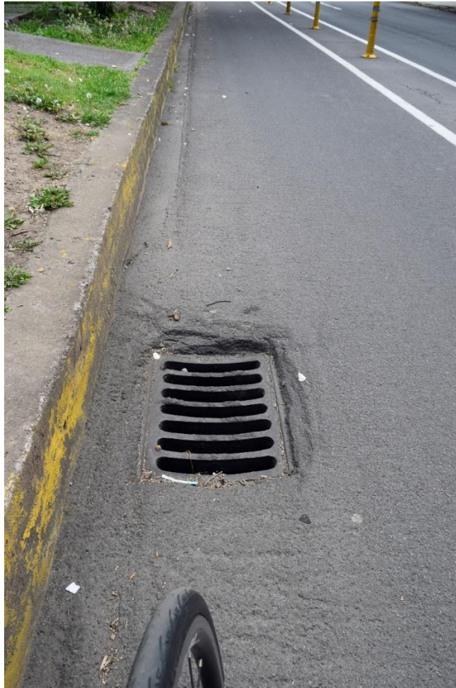
(Fotografía 6. Aguirre, R. 2024, tapa de Alcantarilla obstaculizando ciclovía)
