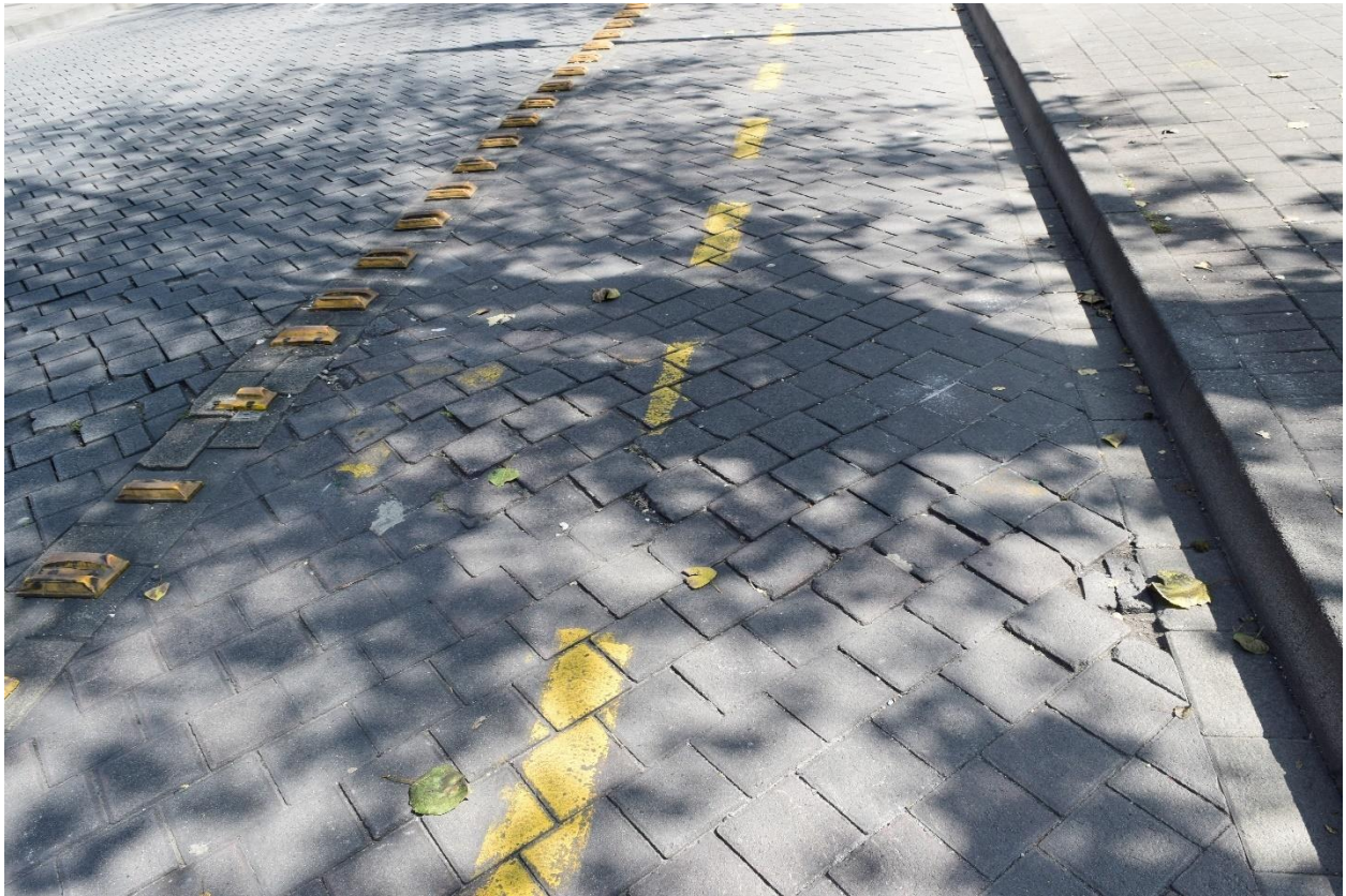
(Fotografía 7. Aguirre, R. 2024, Adoquín levantado en ciclovía de la Av. Amazonas)
