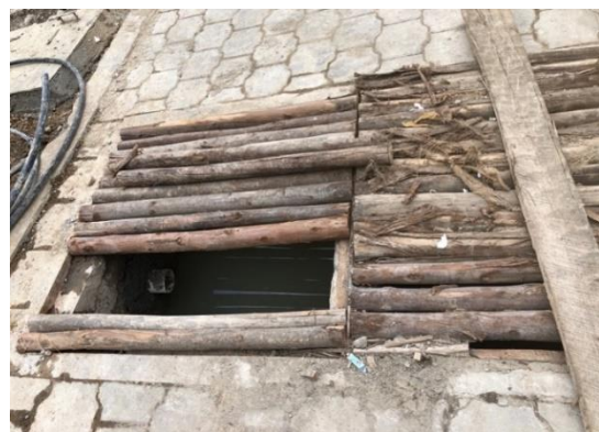
Caja de revisión sanitaria
