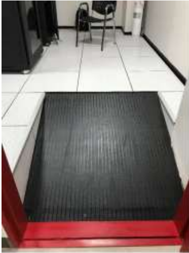
Figura 4: Data-Center Services Fuente: MGR CIA. LTDA.
