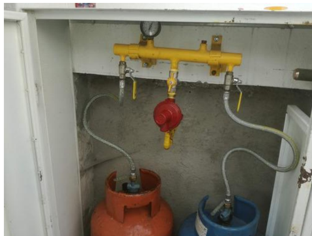
Figura 8. Sistema de conexión centralizado de GLP
