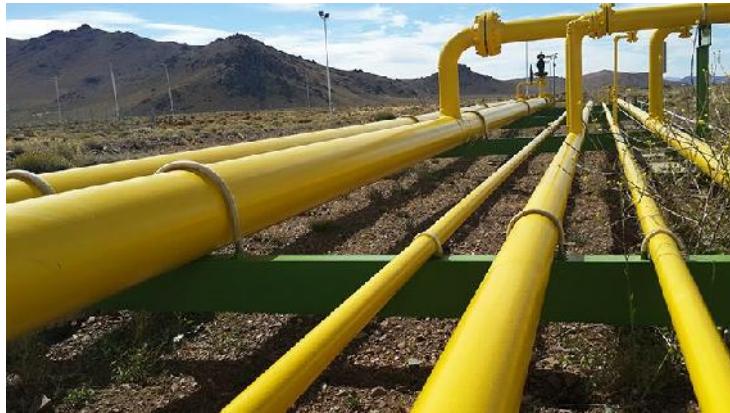
Figura 9. Gasoducto en Vaca Muerta
