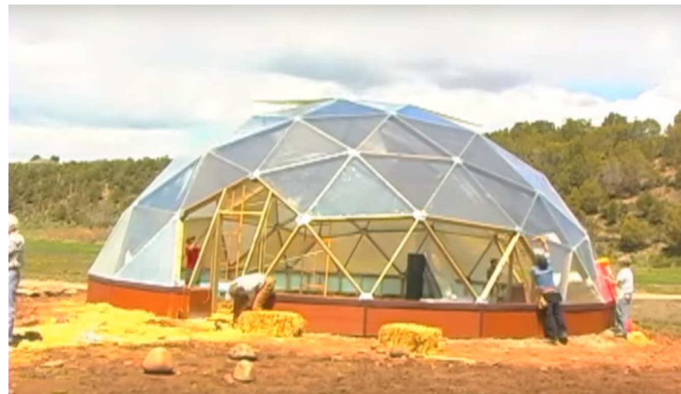
Figura 44: Domo de invernadero con su estructura
