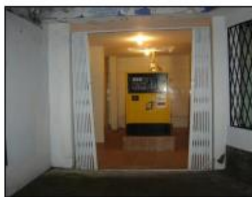
Foto 28. Cuarto del generador ubicado atrás del área de venta de aditivos y lubricantes
