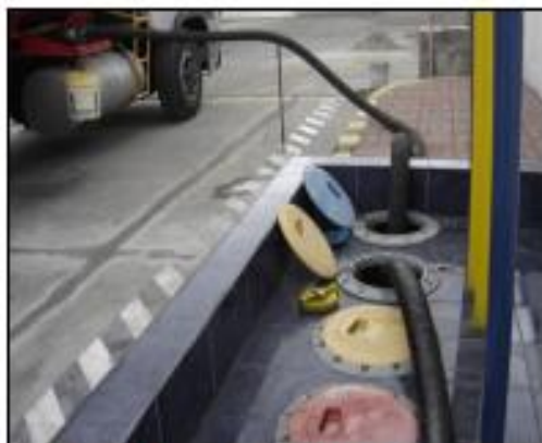
Foto 56. Primer plano del cubeto de protección de manholes
