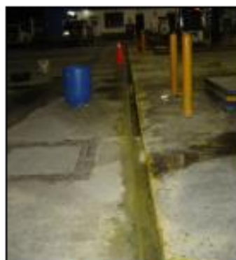
Foto 20. Estado de las canaletas en área de despacho
