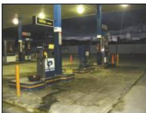
Foto 21. Contenedor de pequeños liqueos en el área de surtidores (lavacara café)
