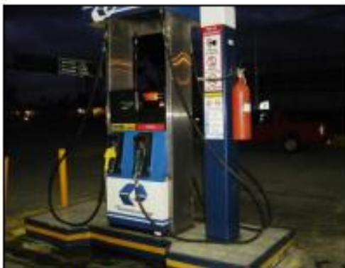
Foto 19. Estado de las mangueras de los surtidores
