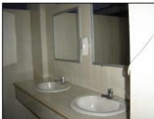
Foto 36. Vista parcial del área de baños y de su estado físico
