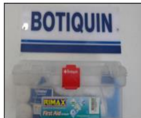
Foto 66. Botiquín ubicado en área de primeros auxilios o sala de personal
