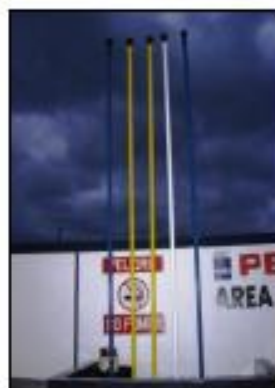
Foto 50. Tubos de venteo
