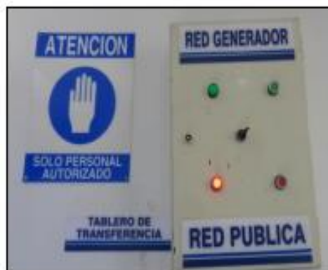
Foto 65. Se observa rotulación en sitios como el tablero eléctrico, generador, etc.
