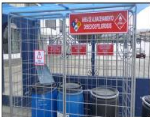
Foto 49. Caseta de almacenamiento temporal de desechos peligrosos
