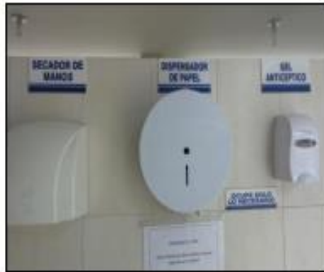
Foto 61. Aditamentos como papel higiénico y otros, ubicados en el área de baños
