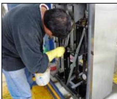
Foto 39. Personal técnico haciendo mantenimiento del equipo de la Estación de Servicio
