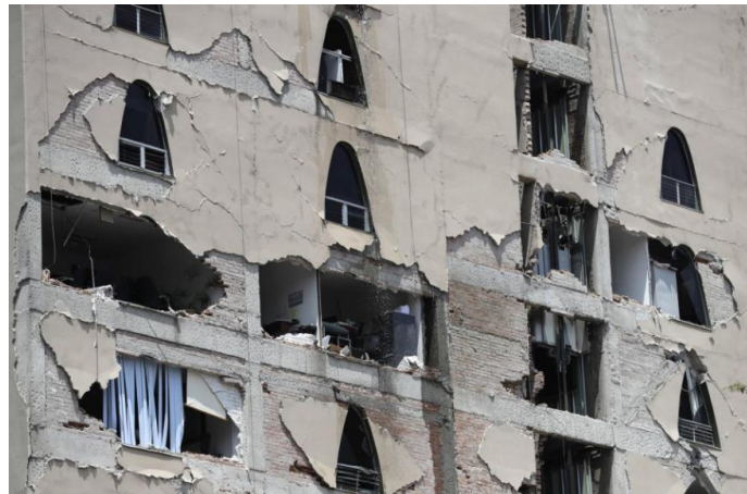
Ilustración 5. Elementos no estructurales afectados por un sismo.
