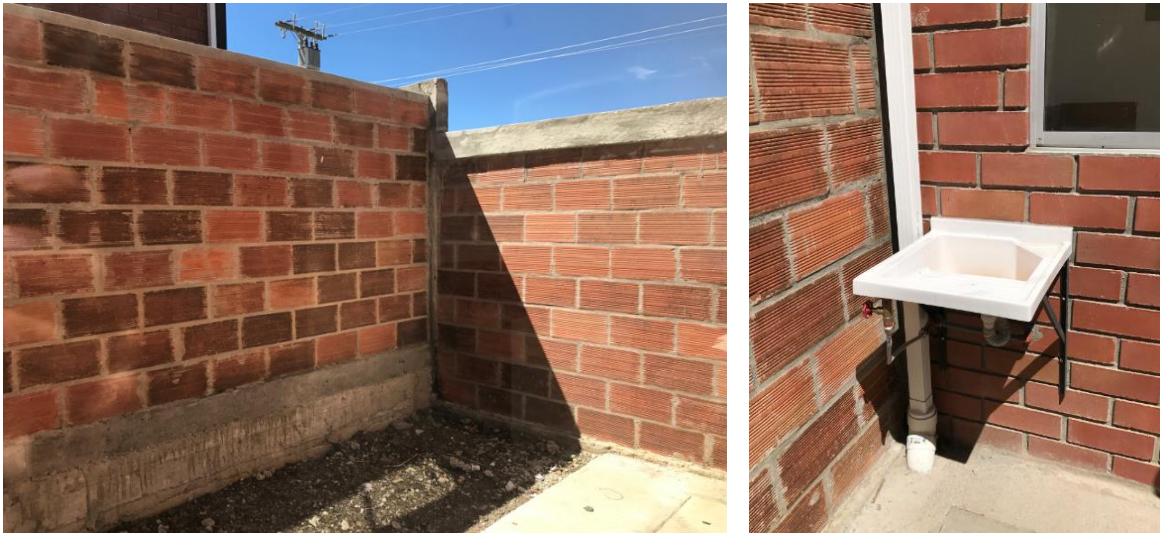
Gráfico 64: Terminados de patio posterior y lavandería de viviendas VIS de la primera etapa. Fotografías por: J. Ponce. Fecha de las imágenes: 20/05/2017.
