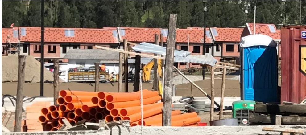
Gráfico 55: Tubería de PVC para cableado del proyecto. Fotografía por: J. Ponce. Fecha de la fotografía: 20/05/2017.
