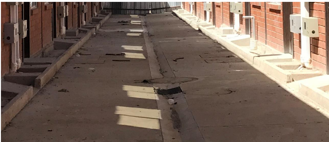
Gráfico 49: Sumidero de vía peatonal del proyecto.
