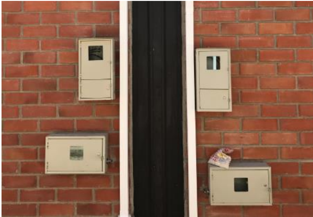
Gráfico 85: Medidores eléctricos y de agua potable de viviendas tipo 1 y 2. Fotografía por: J. Ponce. Fecha de la imagen: 20/05/2017.
