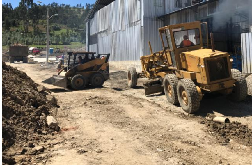
Gráfico 32: Obras de movimiento de tierras para vías de acceso a viviendas del proyecto. Fotografía por: J. Ponce. Fecha de la fotografía: 20/05/2017.
