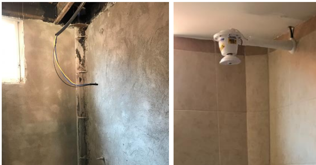
Gráfico 87: Cableado para instalación directa y terminado de ducha eléctrica de viviendas. Fotografías por: J. Ponce. Fecha de las imágenes: 20/05/2017.
