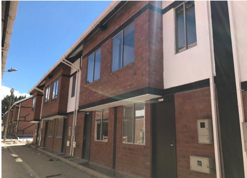
Gráfico 81: Módulos y juntas de construcción de viviendas de la primera etapa del proyecto. Fotografía por: J. Ponce. Fecha de la imagen: 20/05/2017.
