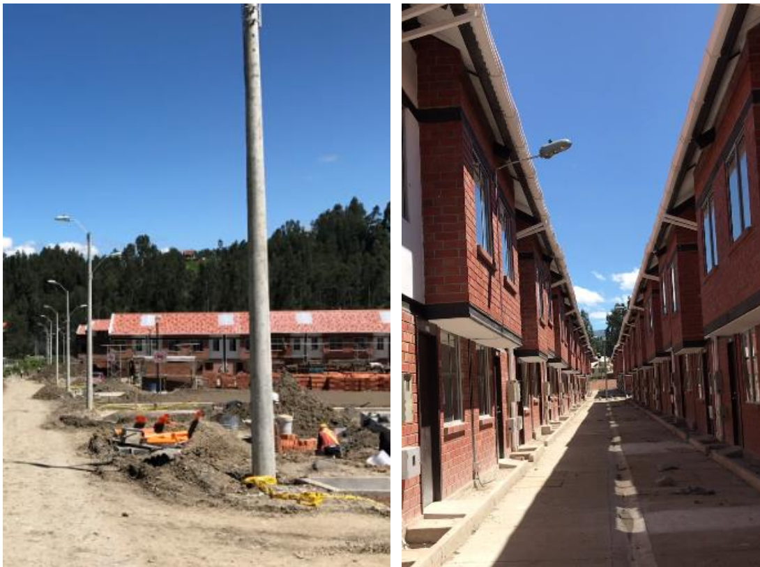
Gráfico 54: Postes de luz de hormigón armado de 14 m. y 10 m. de alto del proyecto. Fotografía por: J. Ponce. Fecha de la fotografía: 20/05/2017.
