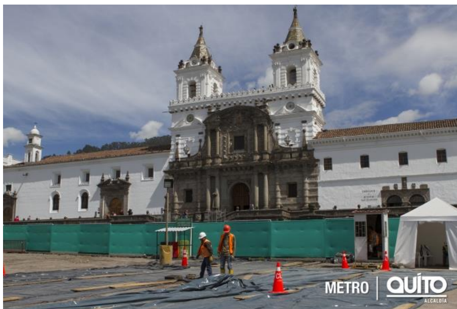
Gráfico 4: Construcción de Estación: Plaza de San Francisco. Fase uno. Metro de Quito. Fuente: Alcaldía de Quito, 2017.
