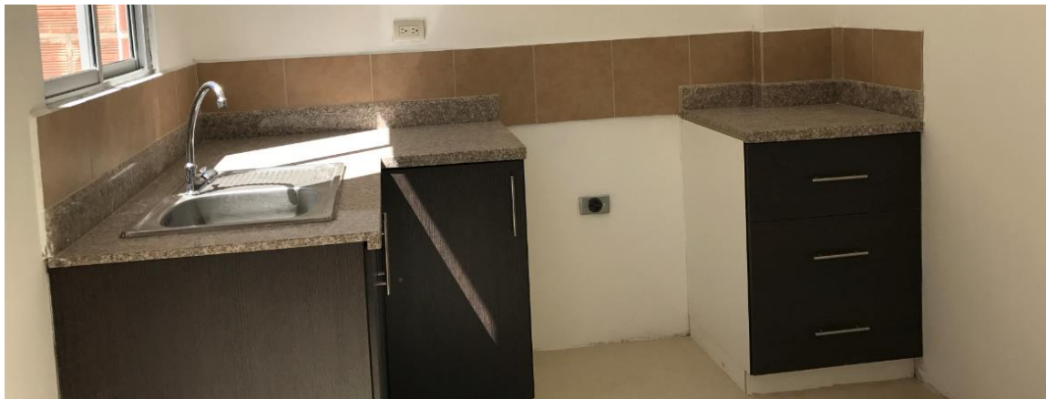
Gráfico 91: Toma directa para cocina eléctrica de viviendas. Fotografía por: J. Ponce. Fecha de la imagen: 20/05/2017.
