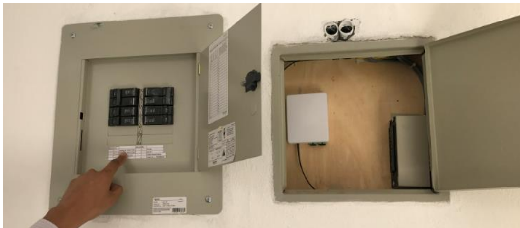
Gráfico 88: Tablero de distribución eléctrica de viviendas. Fotografía por: J. Ponce. Fecha de la imagen: 20/05/2017.
