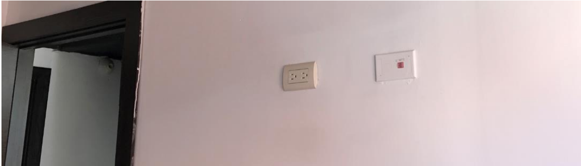
Gráfico 90: Toma corriente y toma de TVCABLE de viviendas. Fotografía por: J. Ponce. Fecha de la imagen: 20/05/2017.
