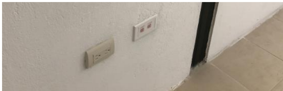
Gráfico 89: Toma corriente y toma telefónica de viviendas. Fotografía por: J. Ponce. Fecha de la imagen: 20/05/2017.
