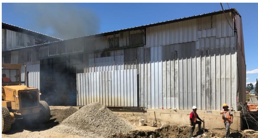
Gráfico 74: Taller de manufactura metálica del proyecto “Los Capulíes”. Fotografía por: J. Ponce. Fecha de la imagen: 20/05/2017.
