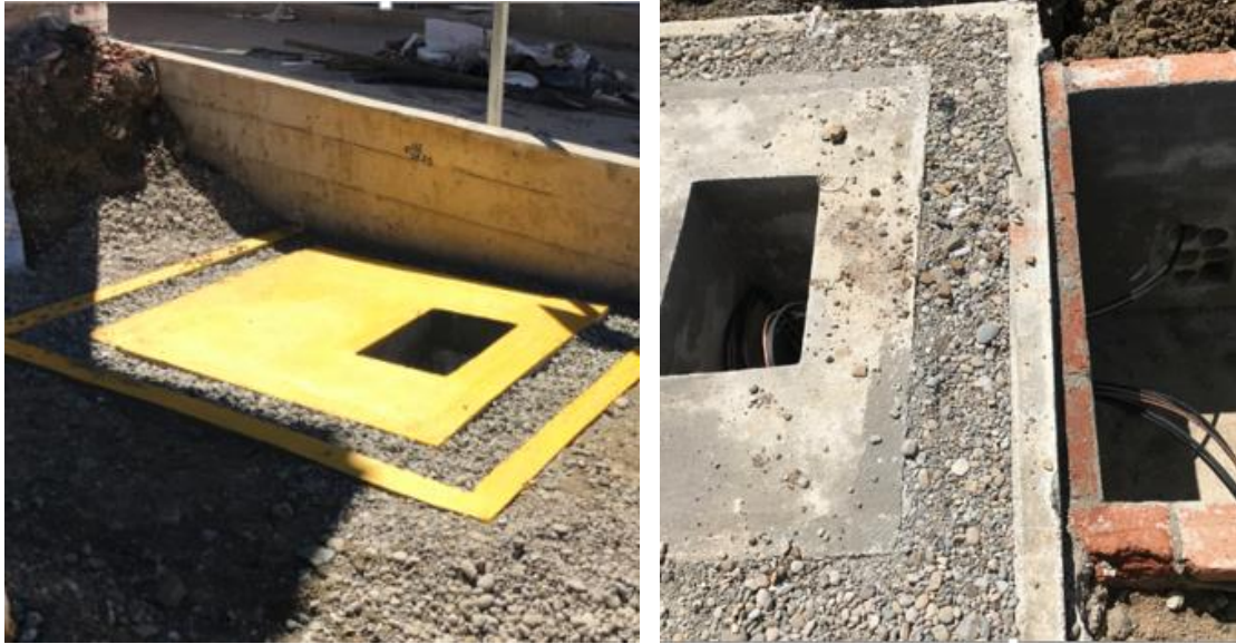
Gráfico 53: Caja de revisión de la red de distribución eléctrica del proyecto. Fotografías por: J. Ponce. Fecha de las fotografías: 20/05/2017.
