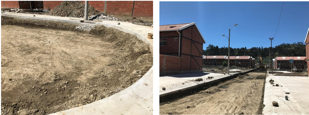
Gráfico 40: Obras de movimiento de tierras y detalle de trazado vial para vías de acceso. Fotografía por: J. Ponce. Fecha de la fotografía: 20/05/2017.
