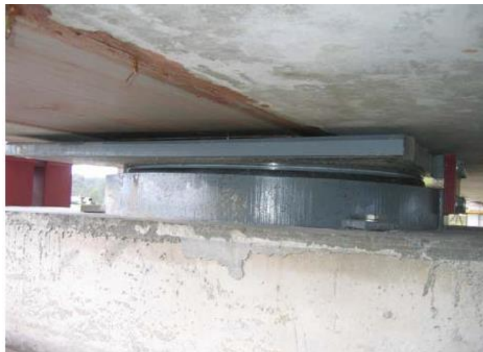
Gráfico 1-12 APOYO FIJO TIPO PF EN PILA DEL PUENTE PEATONAL DE MUISNE Fuente: (Josué Zumba Aguirre, 2016)
