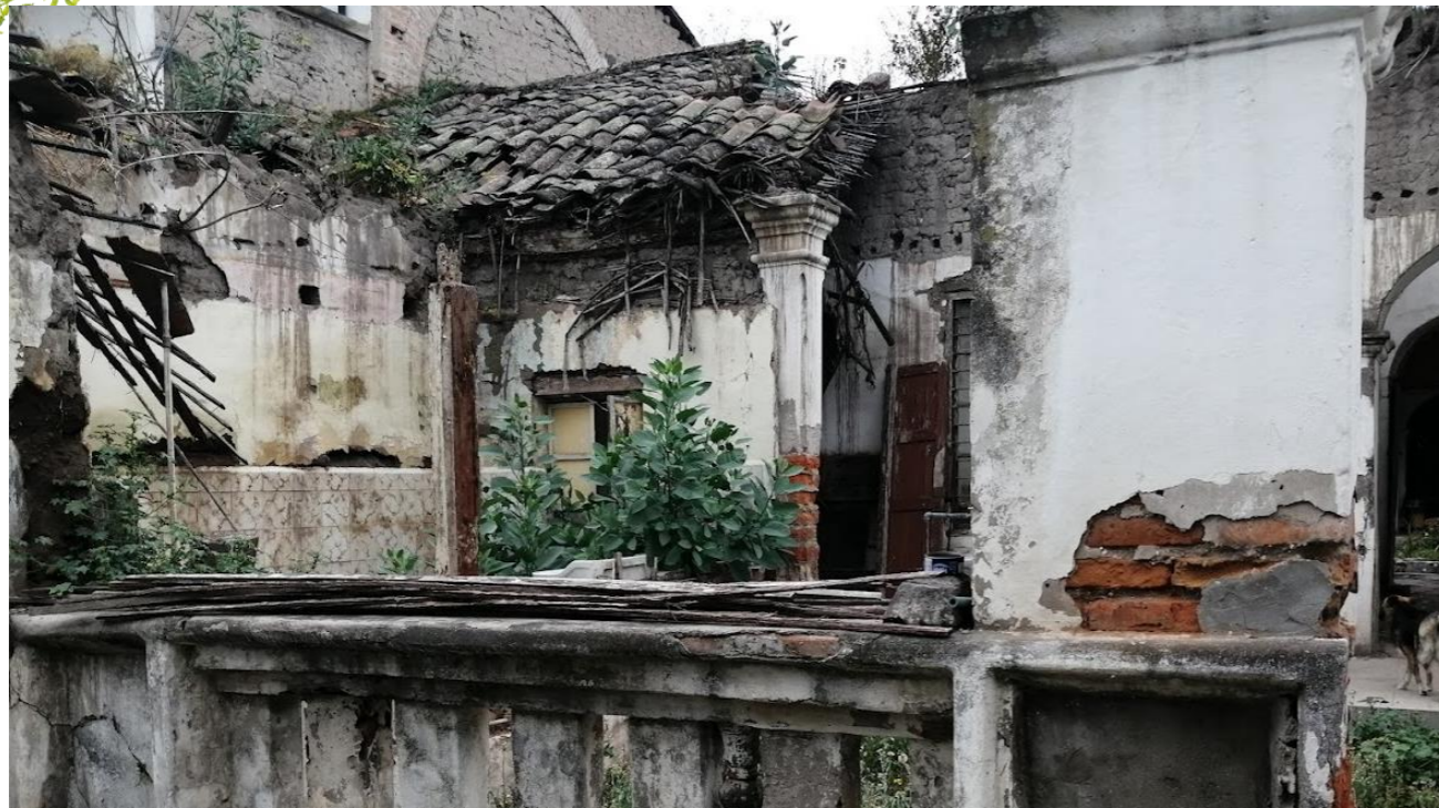
Figura 283. Estado actual cubierta mal estado. Fuente: Elaboración propia.
