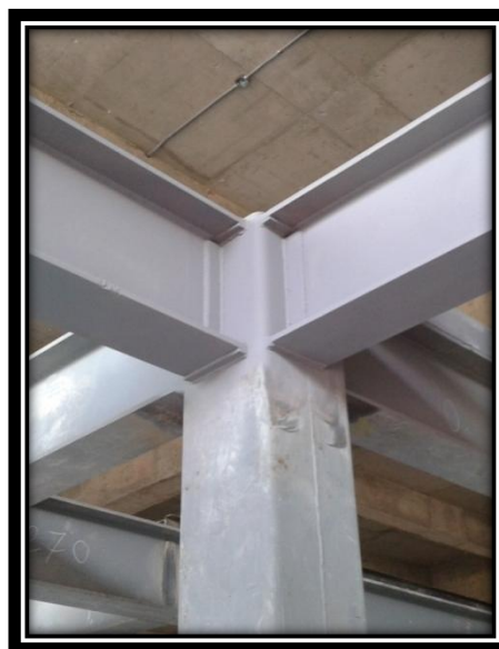
Figura 4. 19. Columna Metálica. Referencia 22.
