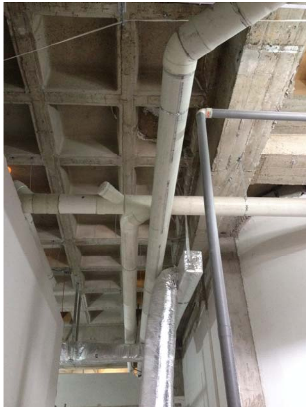
FOTO 10. Fotografía de acoples de instalaciones sanitarias a 45°.
