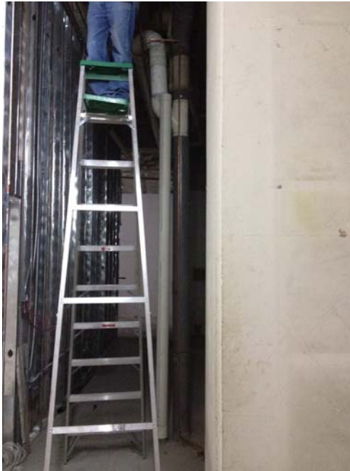
FOTO 23. Fotografía de red de ventilación sanitaria.
