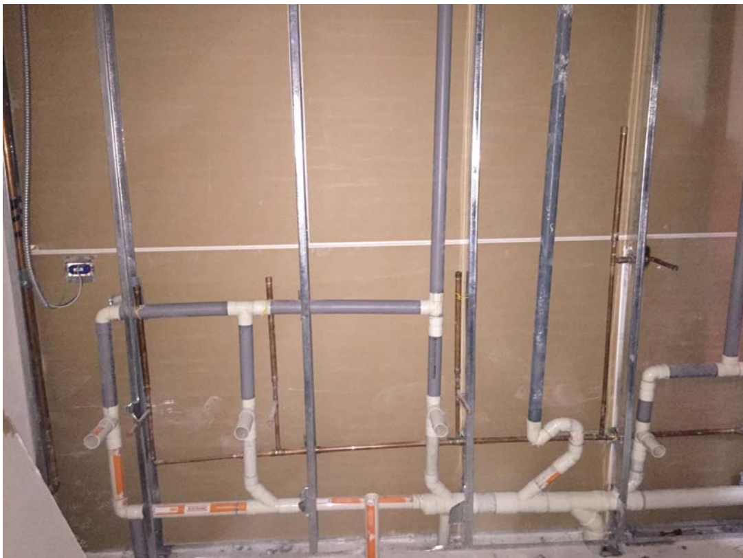
FOTO 24. Fotografía de instalaciones descolgadas bajo losa.
