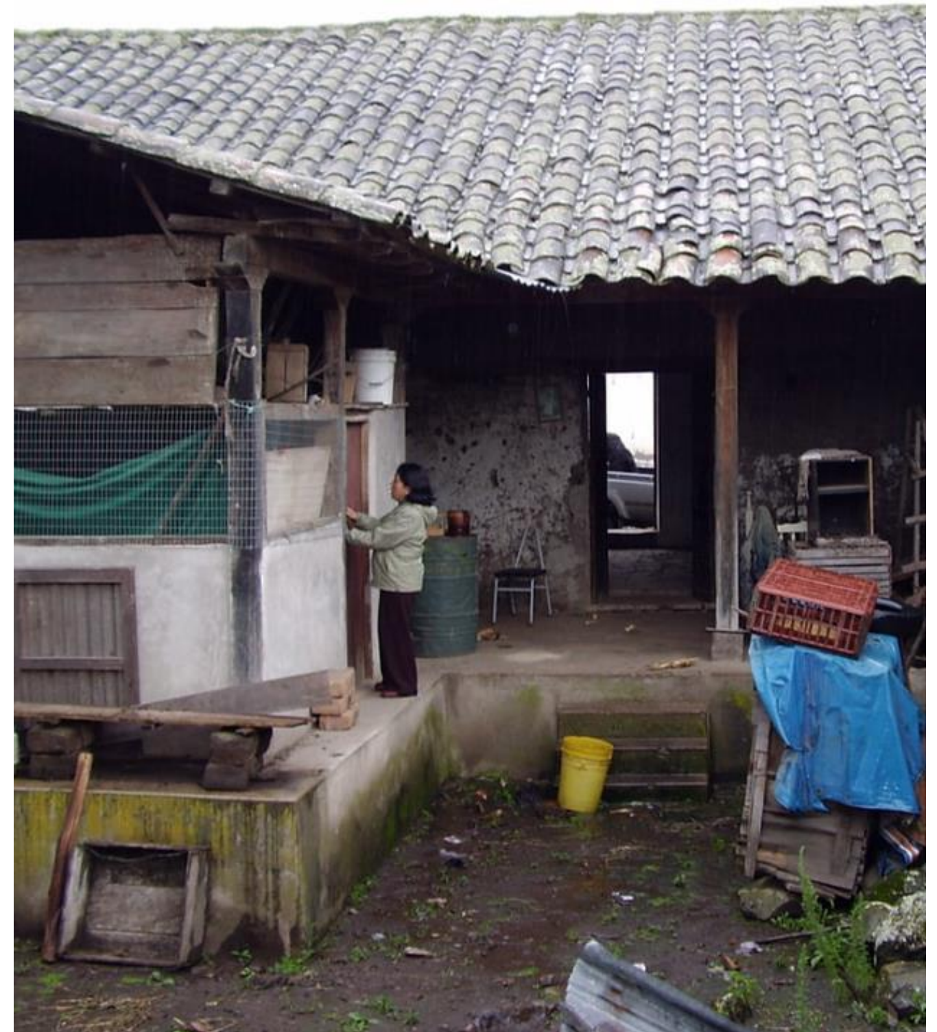
Figura 5: Vivienda en mal estado barrio Santa Isabel Fuente: Propia
