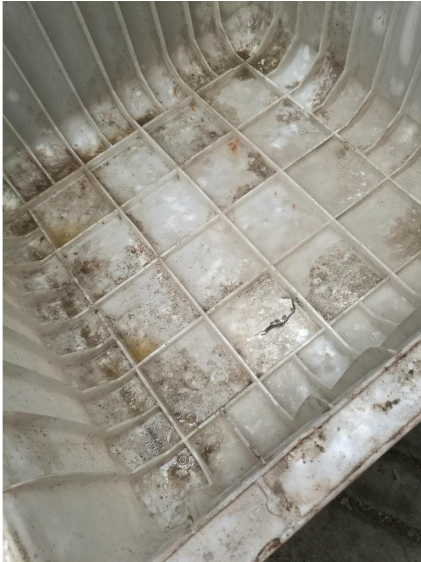
Fotografía 17: Ruptura de casetón por falta de elementos de soporte
