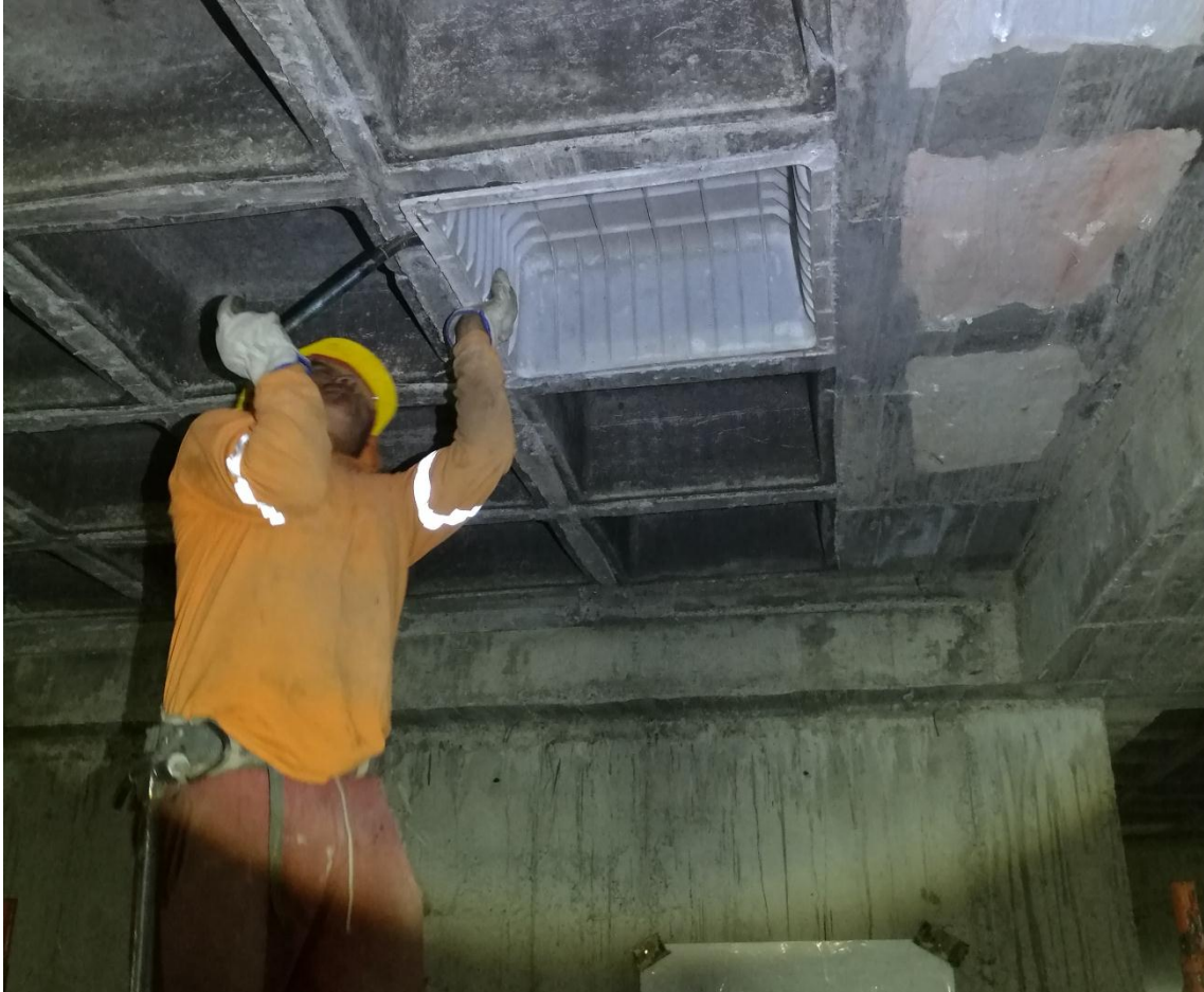
Fotografía 16: Retiro de casetón tradicional con herramienta inadecuada
