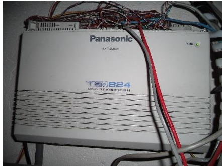
Figura 4.9 Central Telefónica Analógica (fuente: infraestructura empresa vallemotors)
