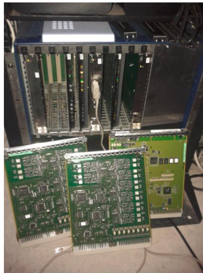
Figura 4.14 Módulos Central Telefónica
