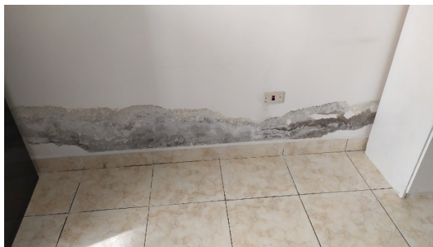
Imagen 4. Pared interior dañada por humedad sin baños cerca
