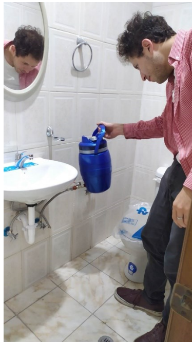
Imagen 28. Drenaje de ramales con tanque de suministro de agua.
