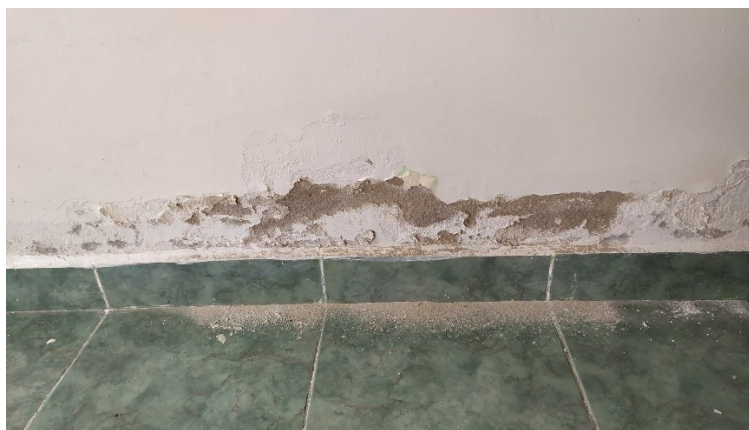
Imagen 1. Pared dañada por humedad de un aula clausurada
