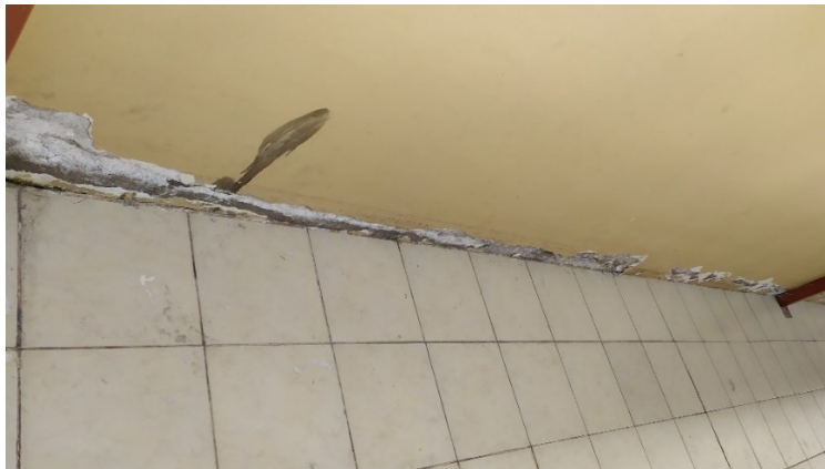
Imagen 3. Daño extendido por humedad (pared interior)
