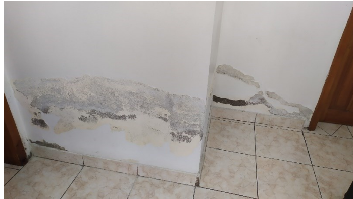
Imagen 5. Pared dañada por fugas en tubería de baños contiguos
