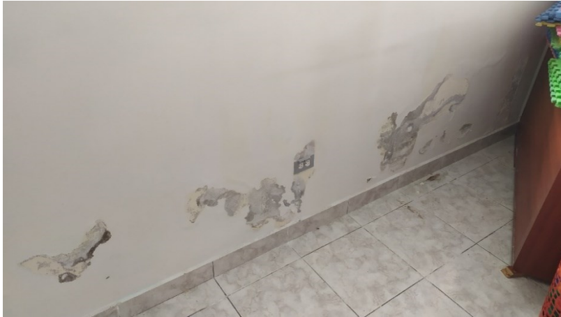
Imagen 2. Pared dañada por humedad de un aula clausurada.
