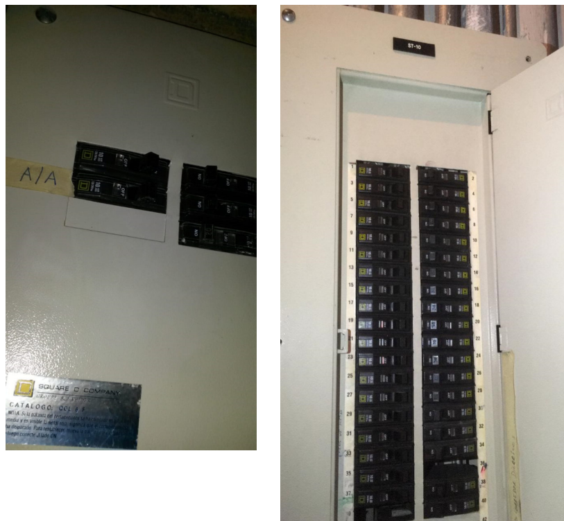
Figura 32.- Centro de Carga Hab. (Fig. Izq.) y Tablero de Piso de Hab. (Fig. Der.) Fuente: Archivos HSQ
