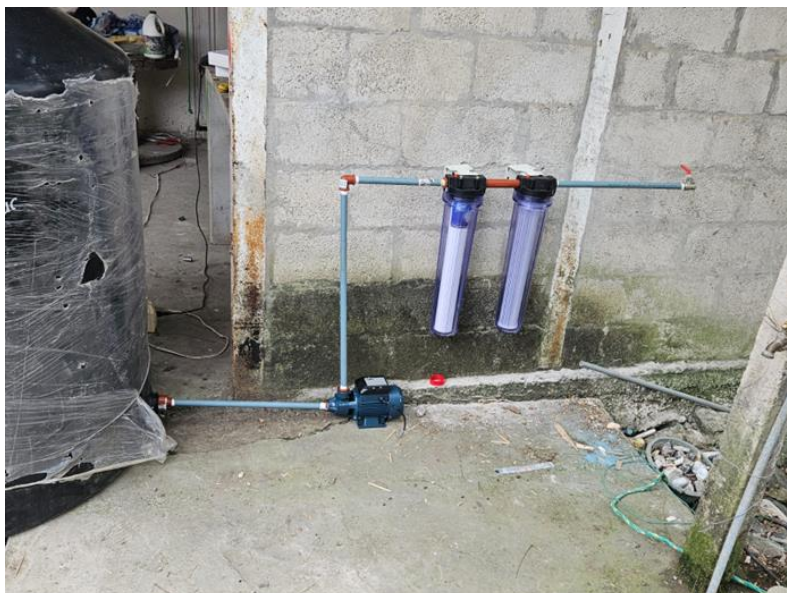
Ilustración 5. Implementación y conexión del tanque de almacenamiento de 1100 litros al sistema de conducción.
