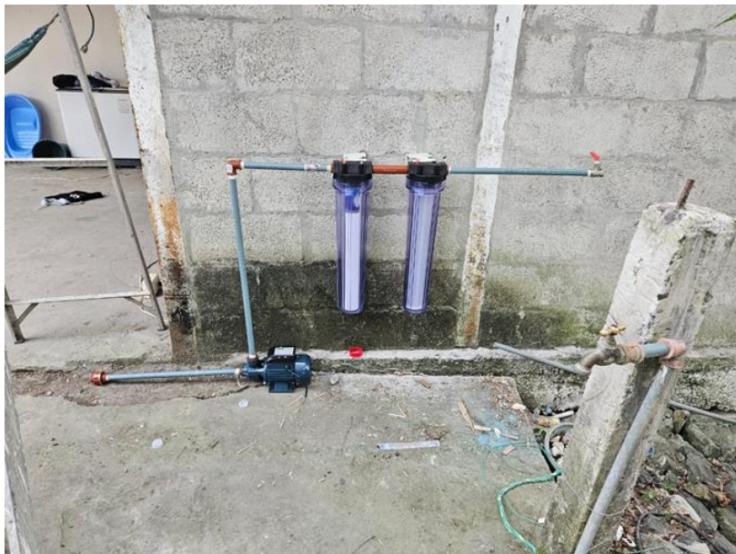
Ilustración 4. Implementación de bomba de 0,5 hp, sistema de conducción con tuberías de 3/8" y válvula de cierre de bola.
