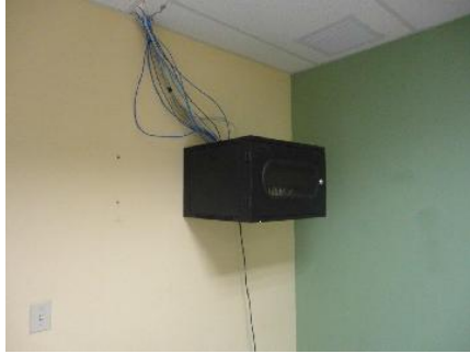
Fig. 4.- Rack aéreo 9 Fuente: Propia
