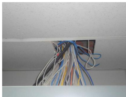
Fig. 11.- Estado del sistema del cableado vertical
