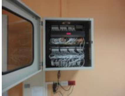
Fig. 5.- Rack aéreo 2 Fuente: Propia
