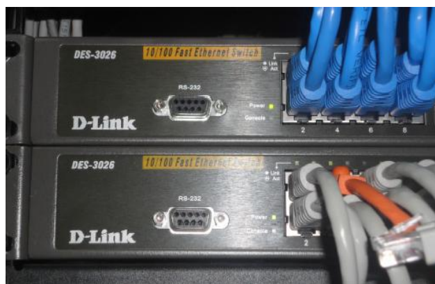
Fig. 14.- Dispositivo de conmutación D-Link
