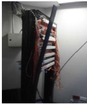
Fig. 7.- Rack 3 Fuente: Propia
