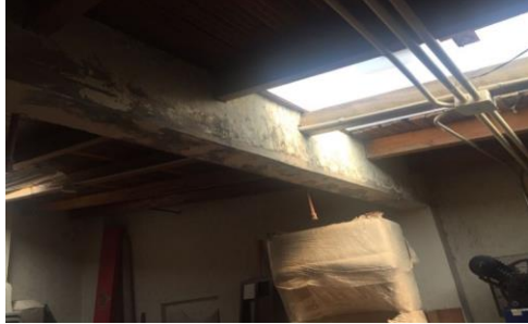
Fotografía 6. Filtraciones e iluminación deficiente
