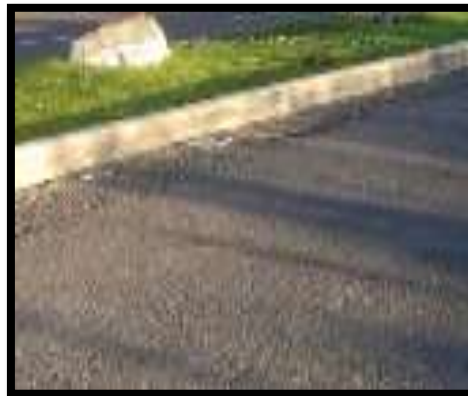
Ilustración 2–7. Oxidación y Deterioro: Pérdida de Finos
