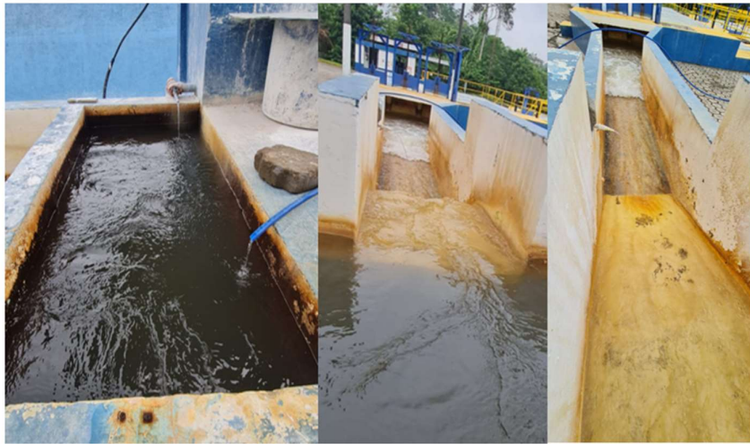
Fotografía No 3: Tanque previo a la canaleta Parshall y canaleta Parshall
