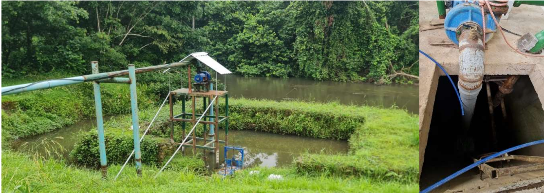
Fotografía No 1: Captación del río Eno, su bomba y la bomba sobre el cárcamo
