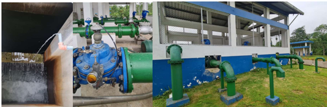
Fotografía No 7: Ingreso de cloro al agua potabilizada y cuarto de máquinas para conducción a los tanques de reserva
