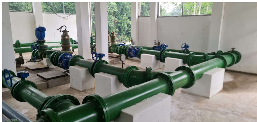
Fotografía No 2: Sistema de tuberías y bomba desde el cárcamo hacia los tanques reguladores de caudal
