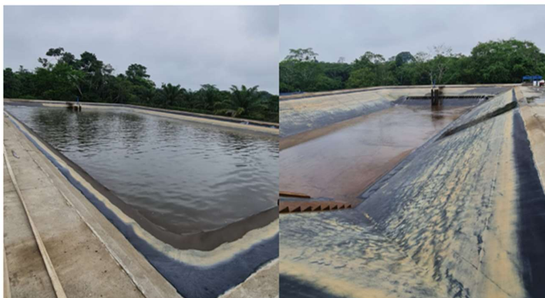
Fotografía No 8: Tanques reguladores de caudal
