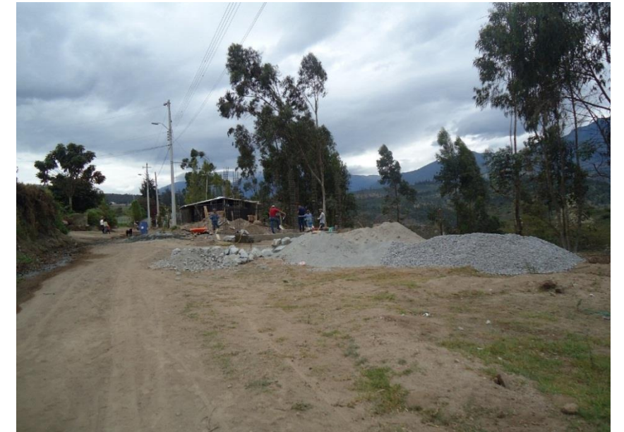
Imagen 72: Construcción sin supervisión técnica Fuente: Visita de campo parroquia Urcuquí Realización: Propia G.A.
