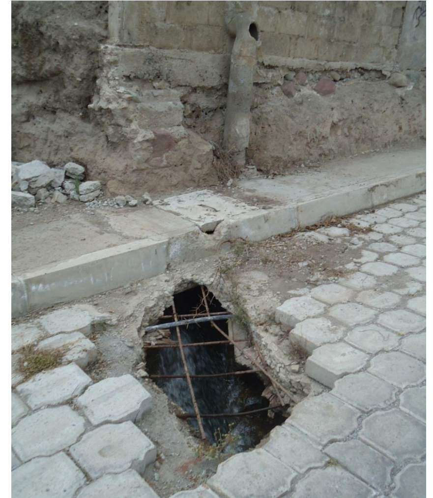
Imagen 80: Vías mal estado Fuente: Visita de campo parroquia Urcuquí Realización: Propia G.A.
