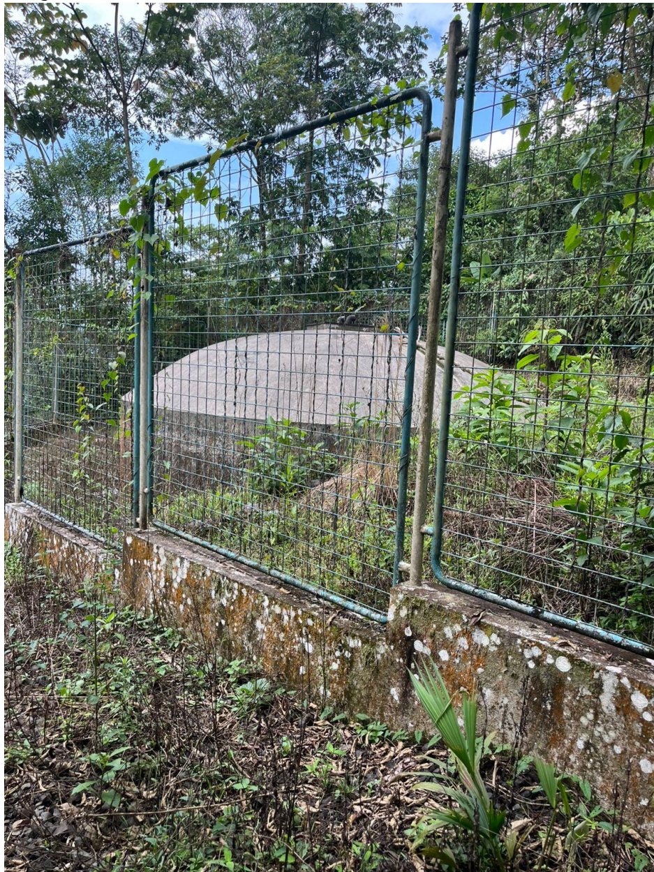
Tanque reservorio de 100 m 3
