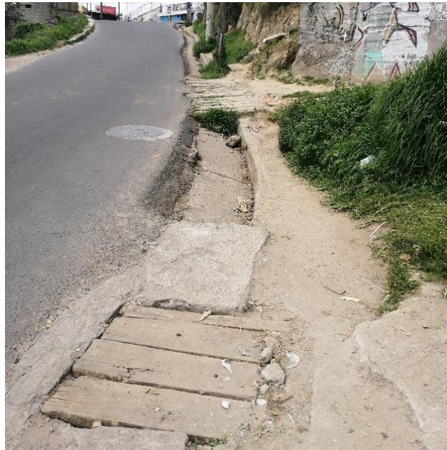
Figura 13. Fotografía de vialidad y veredas en mal estado; elaborado por Verdugo, X. 2020
