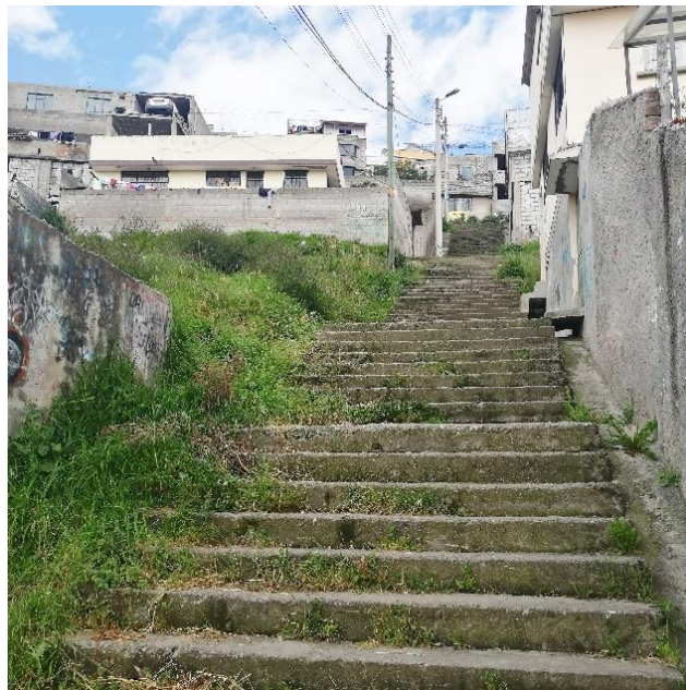
Figura 14. Fotografía de escalinatas en mal estado; elaborado por Verdugo, X. 2020
