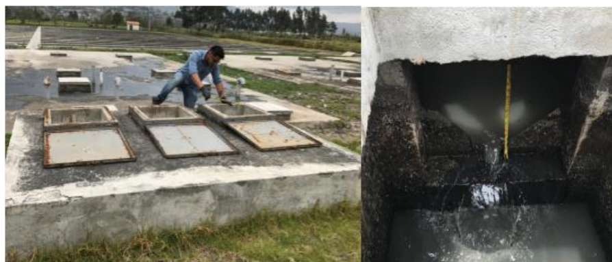
Fotografía 28: Módulos contenedores de vertederos triangulares y vertedero planta depuradora
