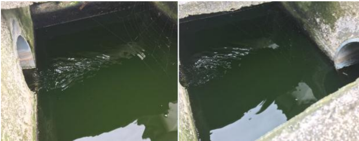
Fotografía 8: Pozo de revisión, en la salida del sistema de tratamiento
