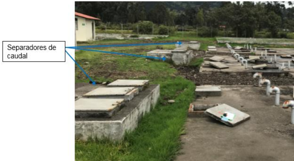
Fotografía 1: Cajas separadoras de caudal
