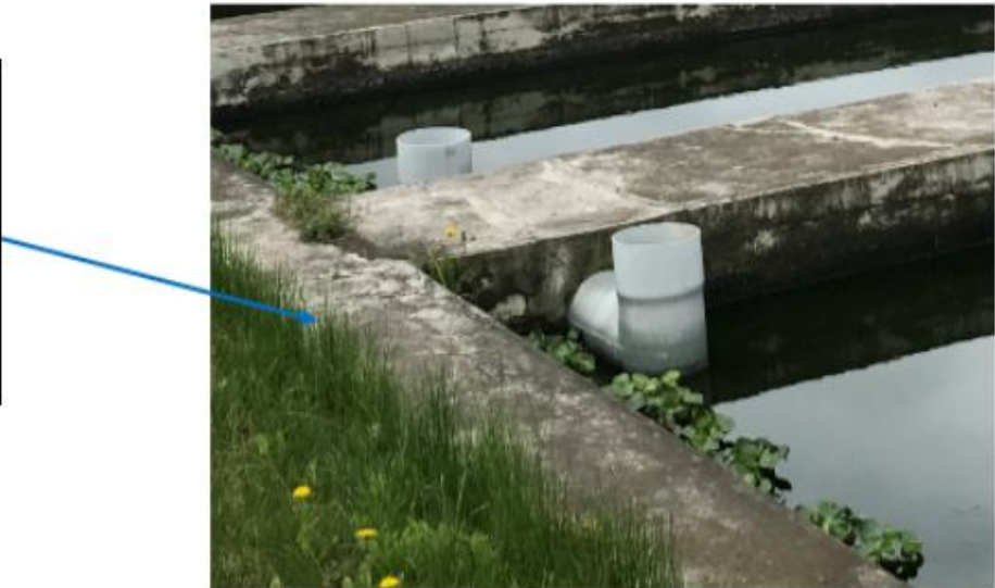
Fotografía 4: Conexión entres estanques de Jacinto de Agua
