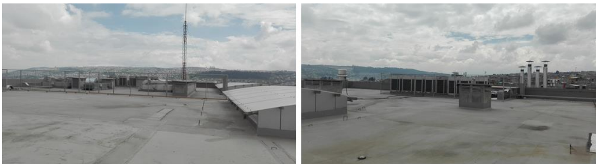
Figura 32: Vista ubicación de equipos de A/A en Terraza del Hospital. Fuente: Fotografía del Autor
