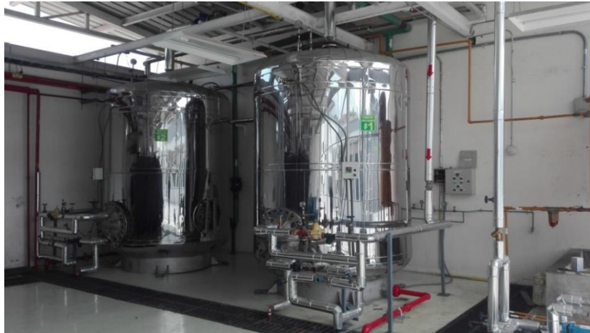
Figura 19: Tanques de Almacenamiento de ACS Fuente: Fotografías del Autor.
