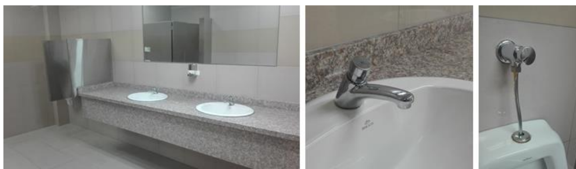
Figura 28: Griferías Instaladas en Baterías Sanitarias del Hospital HGLEA Fuente: Fotografía del Autor.
