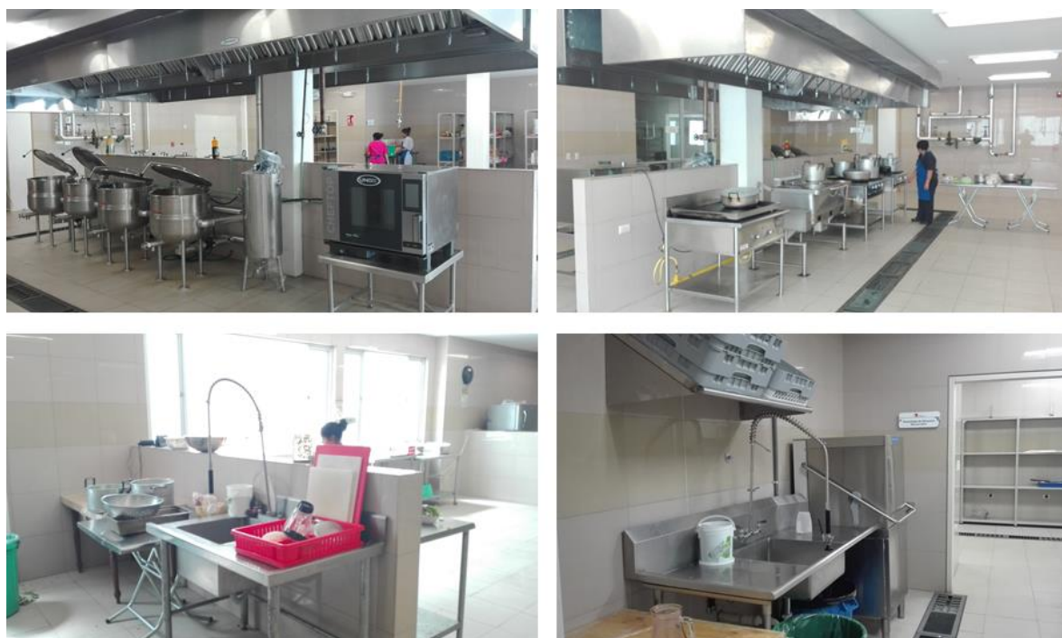
Figura 26: Vistas Interiores Área de Cocción y lavado en Cocina del Hospital. Fuente: Fotografías del Autor
