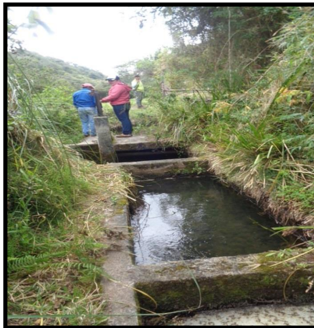
Fotografía 7. Obra de captación acequia Pueblo Viejo
