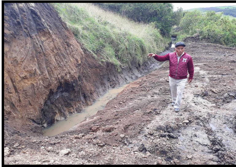
Fotografía 18. Deslizamiento sector Ingueza en la Acequia de Pisquer
