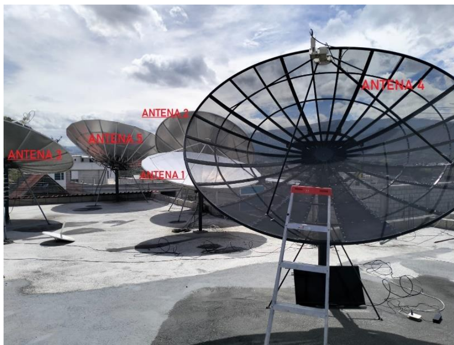
Figura 38. Antenas parabólicas de la empresa Efinet-TV
