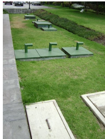
Gráfico 4.9. Cajas de revisión del sistema de aprovechamiento de aguas pluviales
