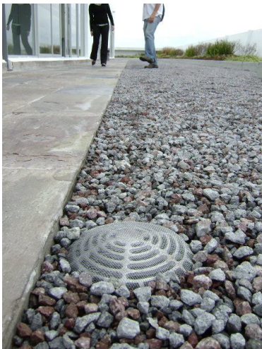
Gráfico 4.8. Rejilla de recolección de aguas pluviales en terraza
