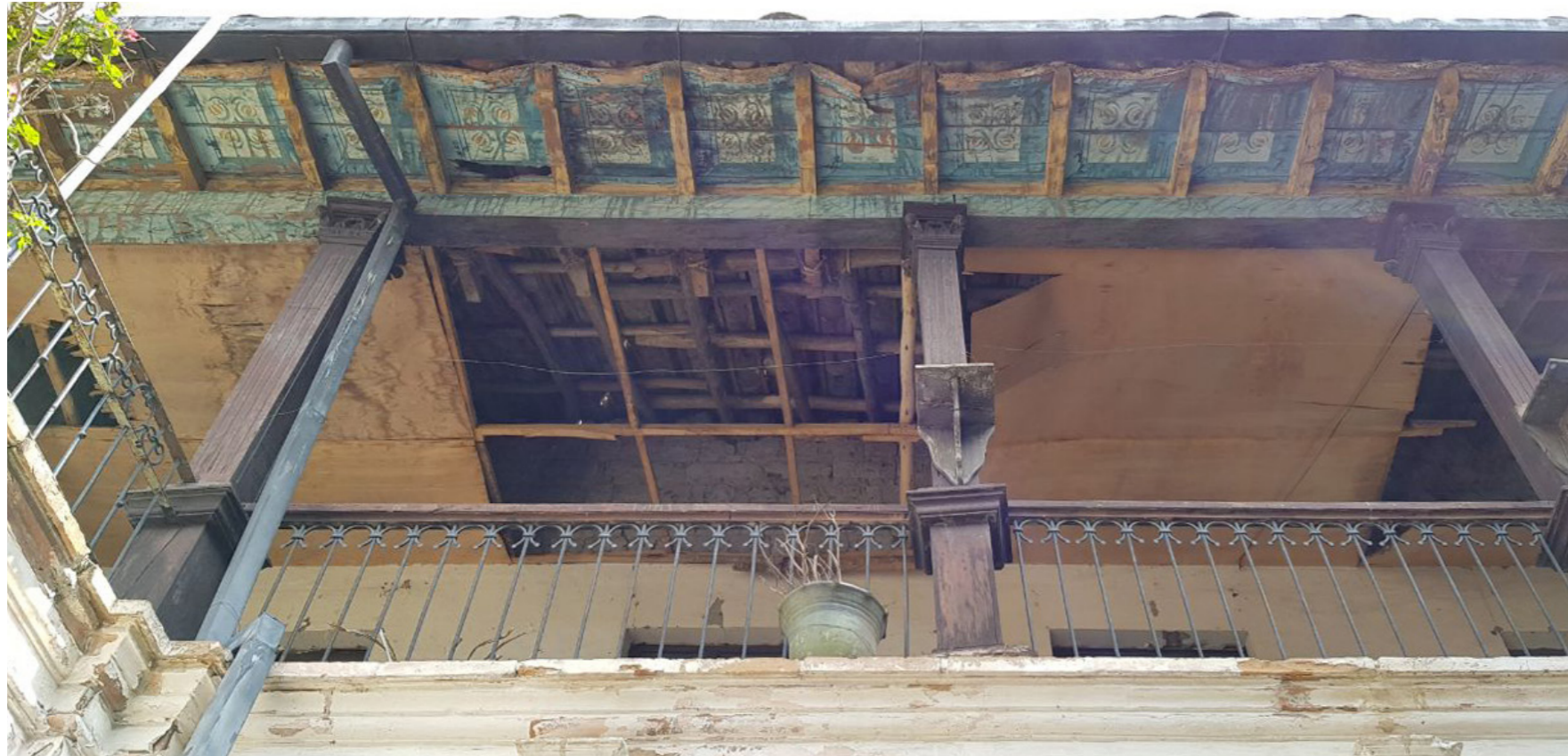
Figura 26. Patologías en inmueble del Centro Histórico - Ibarra Fuente: Sara Cachimuel, 2018
