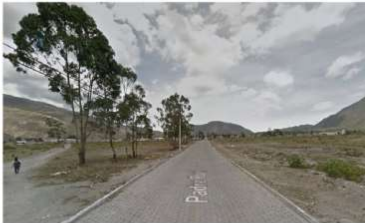
Figura 38: Estado calles en San Antonio de Pichincha
